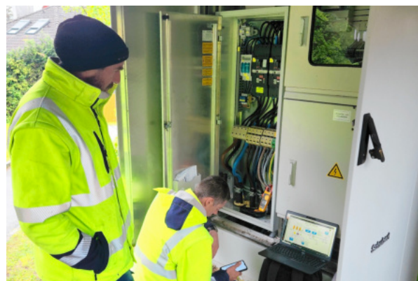
Die Hofer Stromversorgung ist gesichert. Foto: Gemeinde Hof
