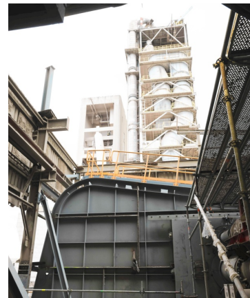
▲ Rund zehn Millionen Euro investierte Holcim in die neue Dekarbonisierungsanlage. Foto: Holcim Österreich/ S. Germershausen
