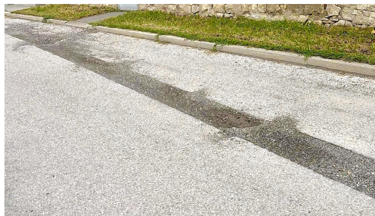
▲ Eigentlich sollten die Arbeiten Ende August fertiggestellt sein. Doch der Zustand der Straßen ist zum Teil noch wenig zufriedenstellend. Foto: Stadtgemeinde Mannersdorf
